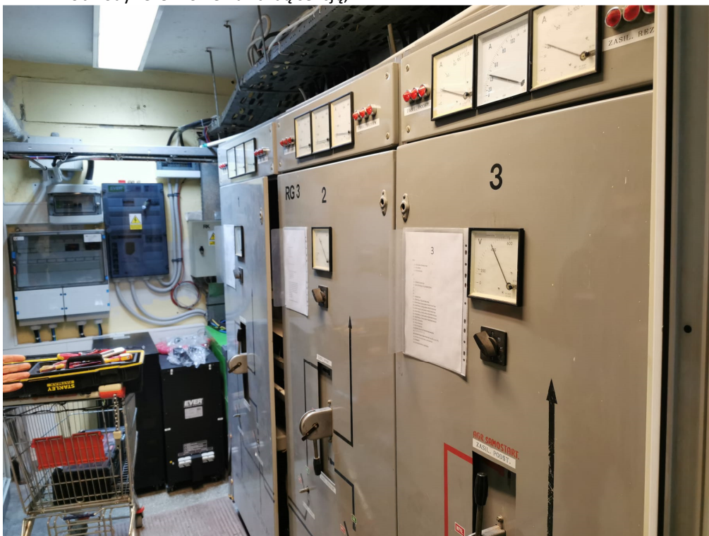
Fot.1 Rozdzielnia istniejąca w BUD .5
