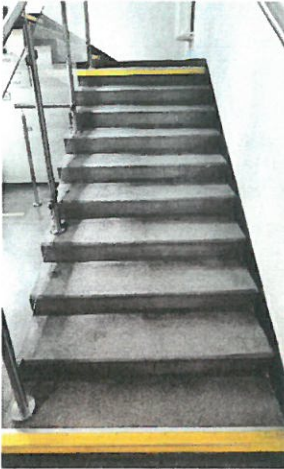
Zdjęcie nr 7: oznaczenie kontrastowe krawędzi schodów w ciągach komunikacyjnych_1
