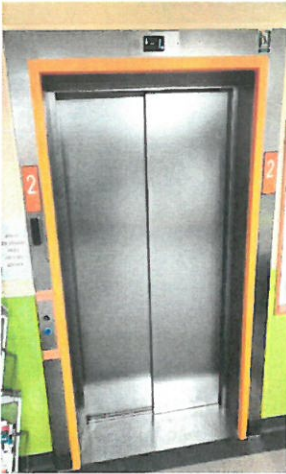
Zdjęcie nr 4: dźwig osobowy_2_1
