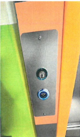
Zdjęcie nr 5: dźwig osobowy_2_2
