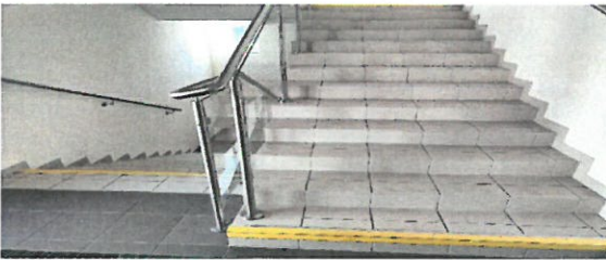
Zdjęcie nr 8: oznaczenie kontrastowe krawędzi schodów w ciągach komunikacyjnych_2
