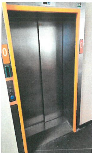
Zdjęcie nr 1: dźwig osobowy_1_1
