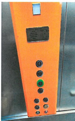
Zdjęcie nr 3: dźwig osobowy_1_3
