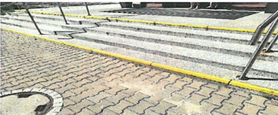
Zdjęcie nr 9: oznaczenie kontrastowe krawędzi schodów w ciągach komunikacyjnych_3
