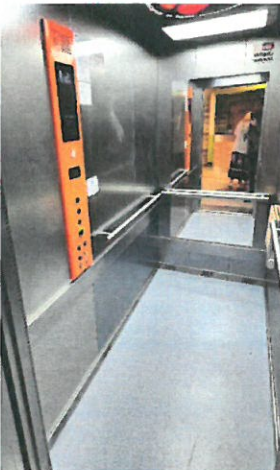
Zdjęcie nr 6: dźwig osobowy_2_3
